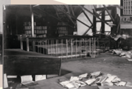
書庫屋根裏の被害
