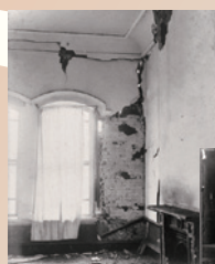
関東大震災の被害
